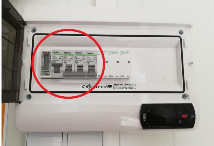
Rys. 15 Widok na rozdzielnicę główną
